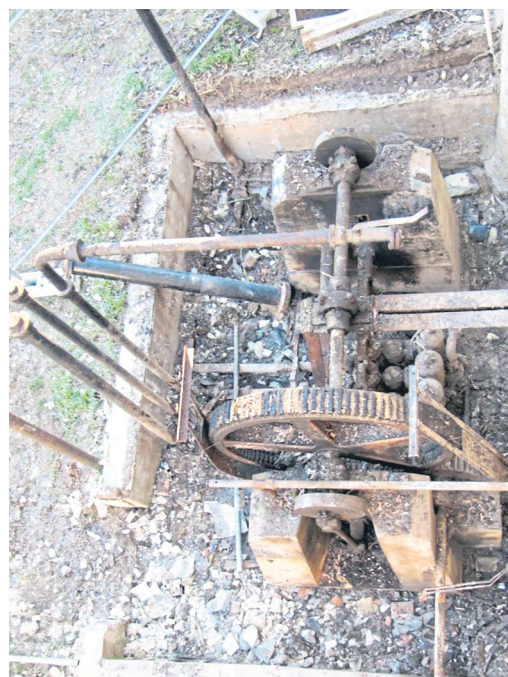
Die Solepumpe des Karlshaller Gradierwerks von 1915.
