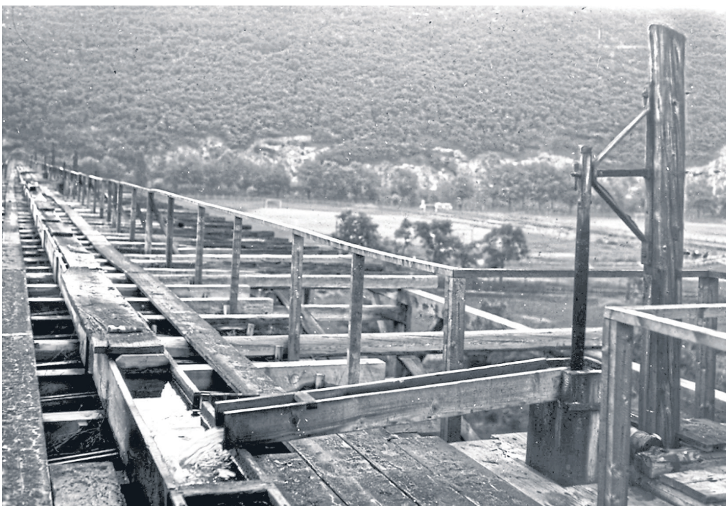
Verteilkanal auf dem Gradierhaus III.
